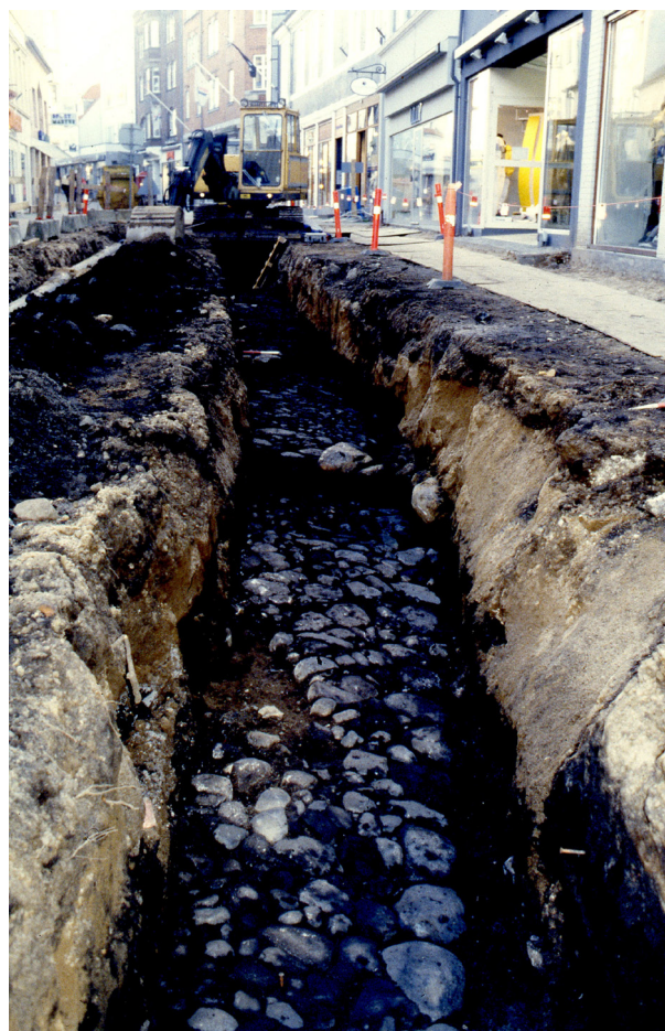
Fig. 5. Udgravning afslørede i 2000 velbevarede gadebelægningslag i Torvegade. Her ses den mere kraftige og markante belægning, antagelig fra midten af 1300-tallet. Foto: Vejlemuseerne.
